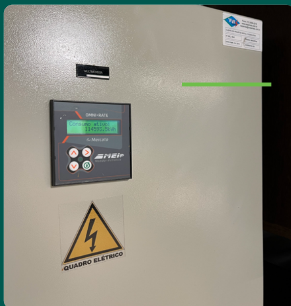
Multimedidor da Mercado permite o gerenciamento energético em tempo real.
